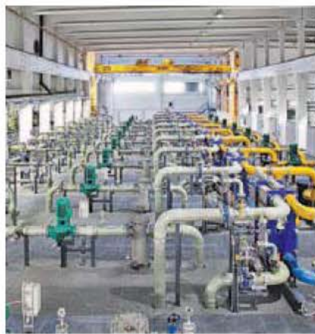
Los técnicos proyectan áreas de refrigeración y ventilación.
